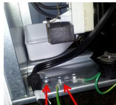
Se deben retirar las pijas del Cable Tomacorriente y de su respectiva Tierra que están pijadas al Soporte Compresor de acuerdo a lo siguiente:
